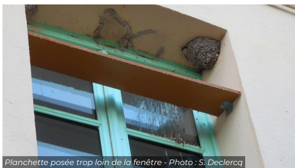
Planchette posée trop loin de la fenêtre - Photo : S. Declercq
